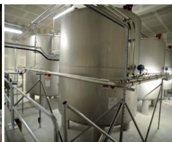
Area di stoccaggio resine
