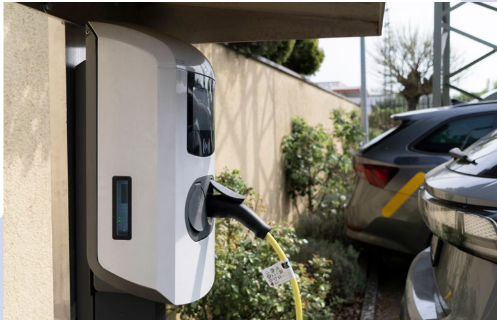
Für Elektrofahrzeuge steht eine eigene Ladeinfrastruktur zur Verfügung
